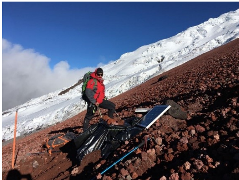
Installation de l'une des stations (Photo : Freddy Vásconez – IG-EPN).
