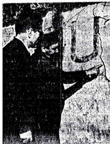
M. Péon, de Limons, montre à M. Dessens une fissure de plusieurs millimètres.
